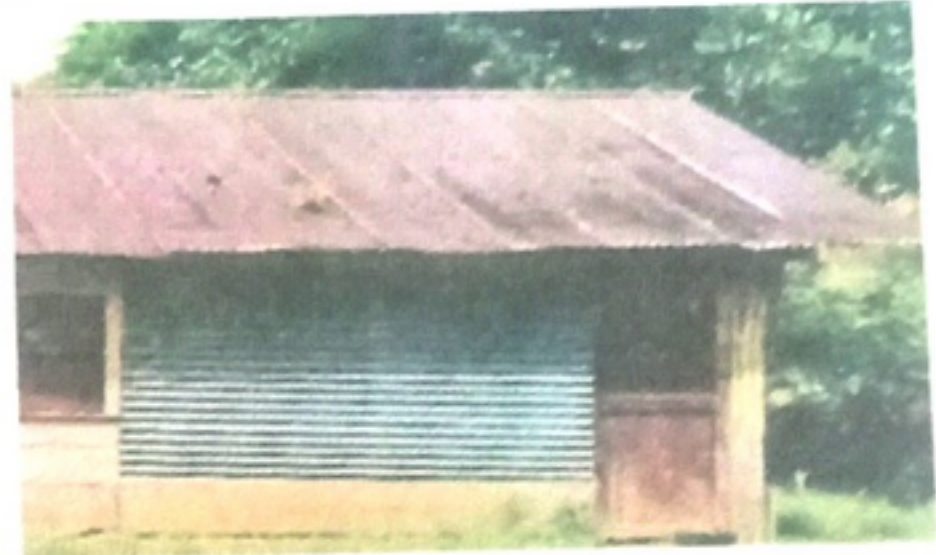
Foto 4: Puerta y ventanas deterioradas
